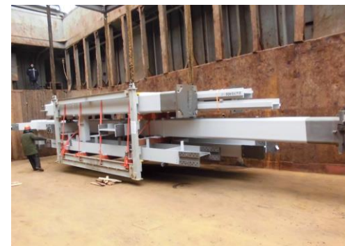
施工管理ラベル付き専用ラックごと現場配置（作業領域に分けて配置）
